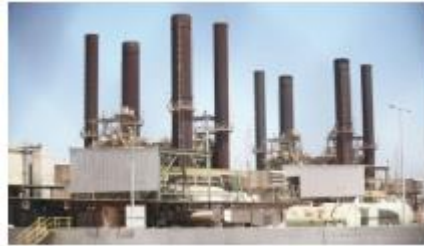
محطة توليد الكهرباء في غزة
