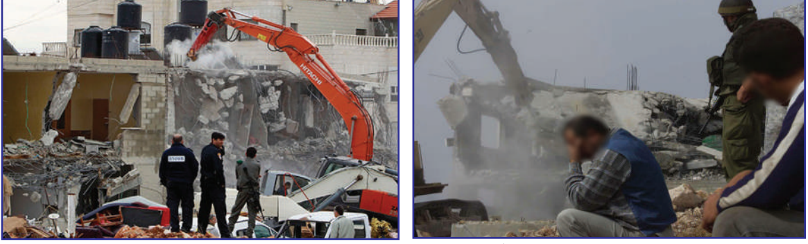
جرافات الإحتلال الصهيوني تهدم المنازل الفلسطينية
