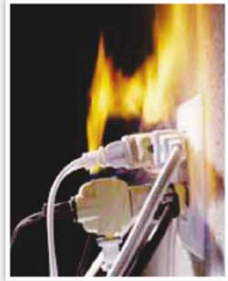
شكل (٢-١٩): زيادة التحميل الكهربى يكون سبباً فى حدوث الحرائق.
