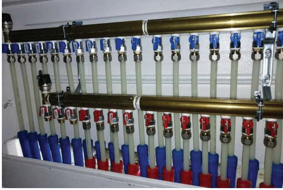
الشكل (4-13): خزانة مجمعات تزويد صحي.
