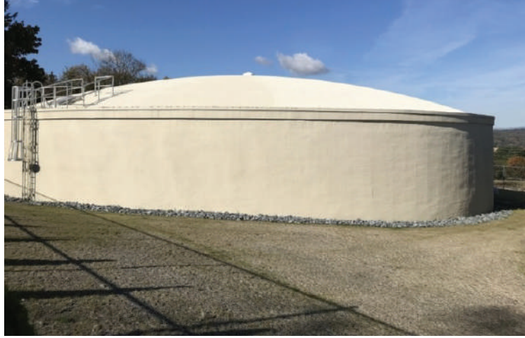
الشكل (3-5): خزان مياه يغذي شبكة حي سكني.
