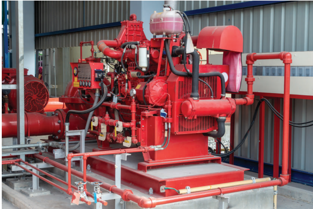
الشكل (4-28): غرفة المضخات.
