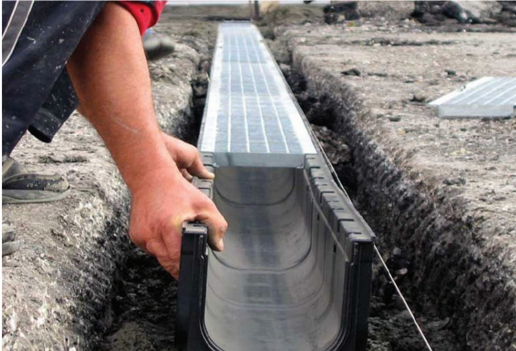
الشكل (37-5): أنابيب تصريف مياه الأمطار.
