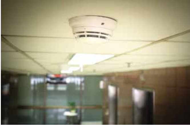
الصورة ٩-١٠ جهاز كاشف للدخان داخل أحد المباني العامة
